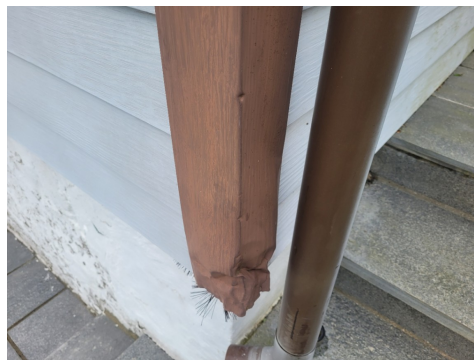
Skade på hjørne.
