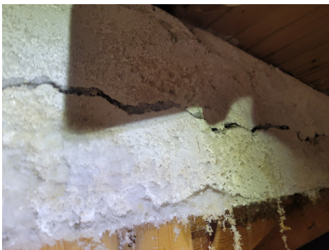
Sprekk i betongdrager og kalkutslag.
