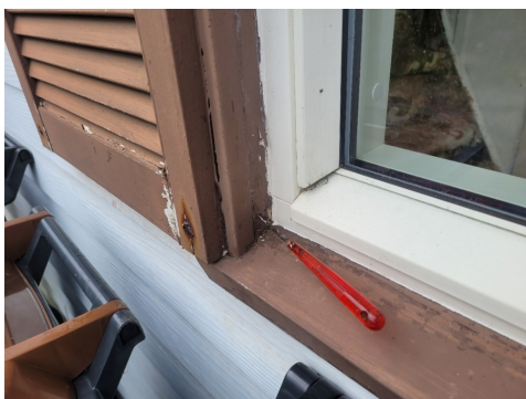
Råte i innfestning til metallkledning.
