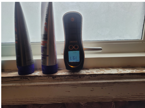
Fuktskader på vindu.
