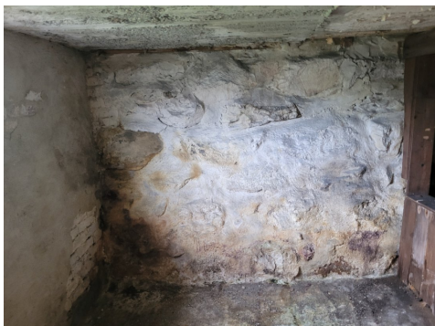
Misfarging og fuktighet.
