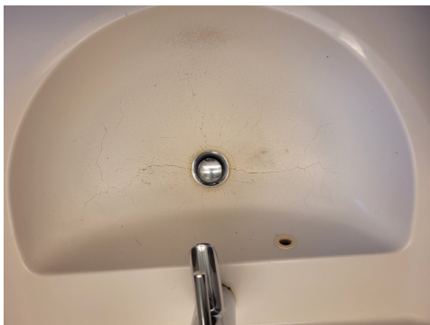
Sprekk i servant.
