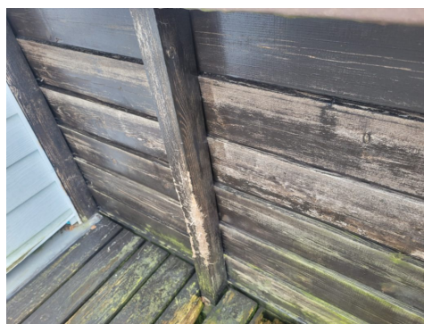
Slitasje og råte.
