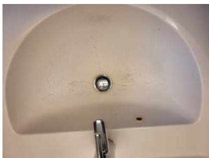
Sprekk i servant.
