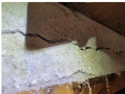
Sprekk i betongdrager og kalkutslag.
