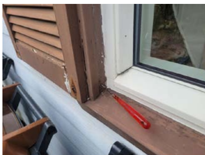
Råte i innfestning til metallkledning.
