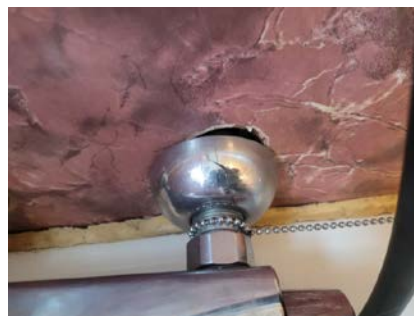
Manglende tetthet rundt rørgjennomføring.
