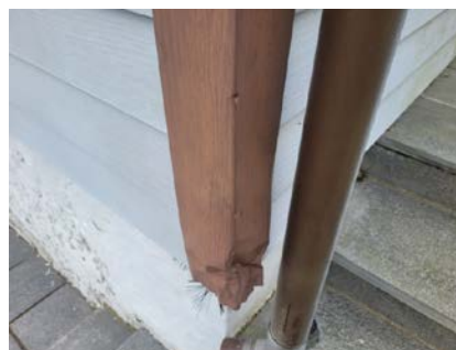
Skade på hjørne.
