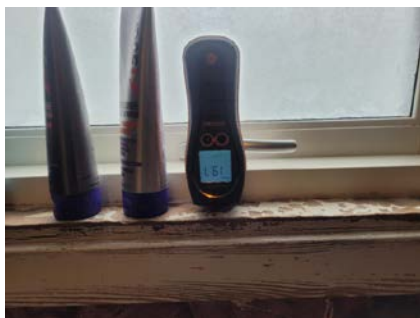
Fuktskader på vindu.
