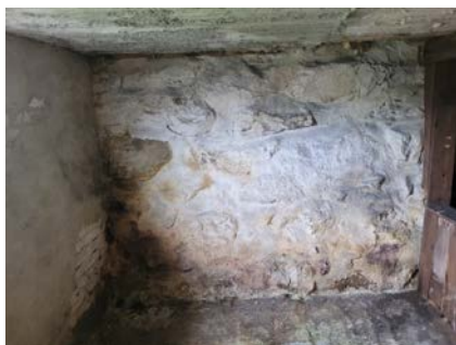
Misfarging og fuktighet.
