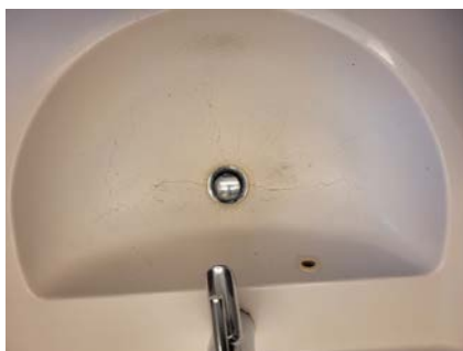
Sprekk i servant.
