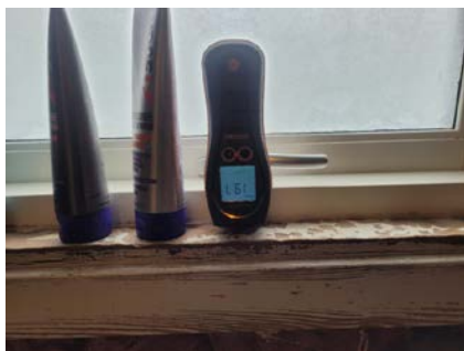
Fuktskader på vindu.
