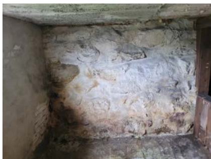
Misfarging og fuktighet.
