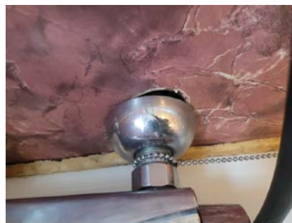
Manglende tetthet rundt rørgjennomføring.
