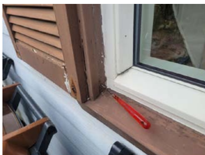
Råte i innfestning til metallkledning.
