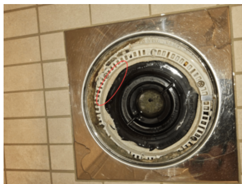
Synlig membran ved klemring i sluk
