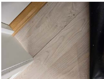
Glippe i laminat skjøt ved inngangsdør
