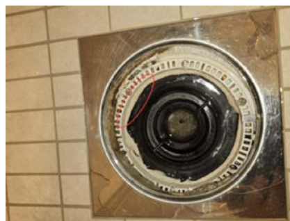
Synlig membran ved klemring i sluk
