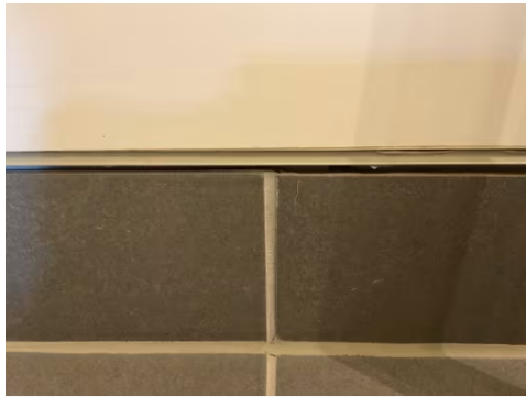
Manglende tetting mellom sokkel og plater.
