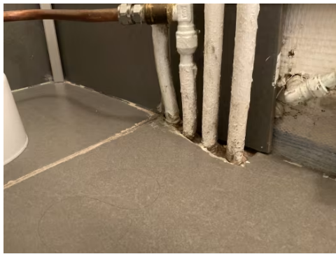
Manglende tetting for gjennomføringer i gulv.
