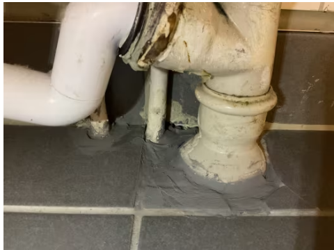
Manglende tetting for gjennomføringer i gulv.
