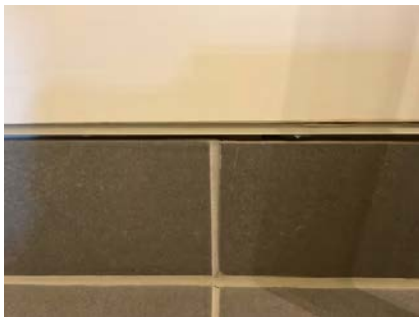
Manglende tetting mellom sokkel og plater.
