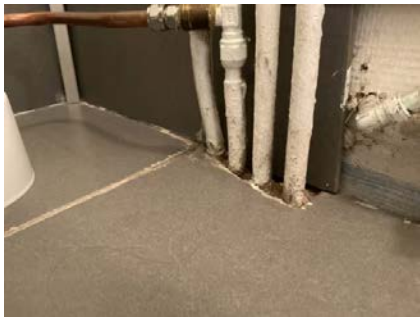
Manglende tetting for gjennomføringer i gulv.
