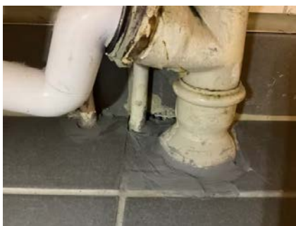
Manglende tetting for gjennomføringer i gulv.
