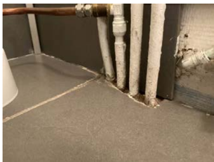
Manglende tetting for gjennomføringer i gulv.
