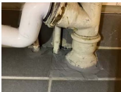
Manglende tetting for gjennomføringer i gulv.
