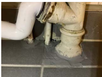
Manglende tetting for gjennomføringer i gulv.
