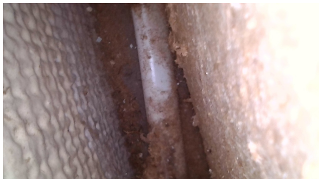
Ledning synlig ved kamerainspeksjon
