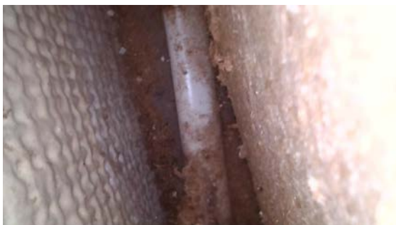
Ledning synlig ved kamerainspeksjon
