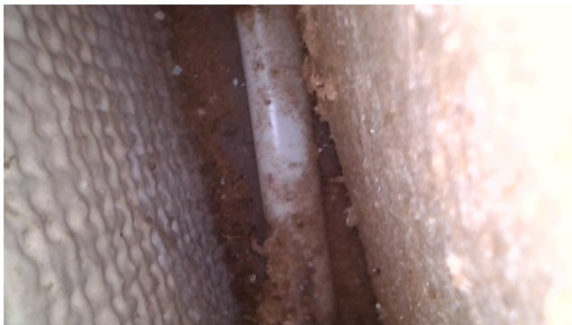
Ledning synlig ved kamerainspeksjon
