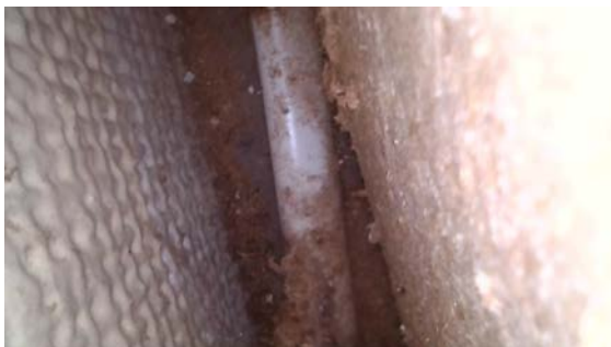
Ledning synlig ved kamerainspeksjon
