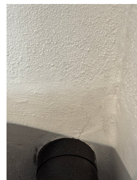
Riss i mur bak peisovn. Anses ikke å være et problem.
