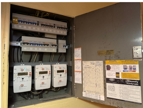
Sikringsskap i fellesarealer.
