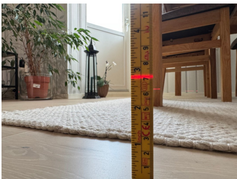
Bilder viser skjevheter i gulv i stue.
