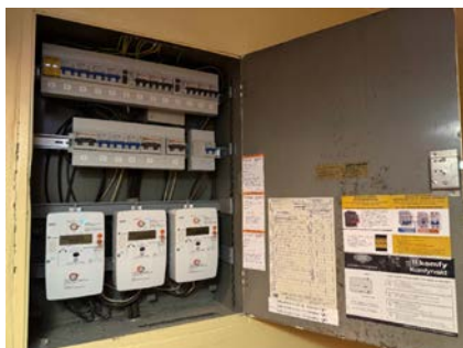
Sikringsskap i fellesarealer.
