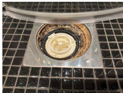
Plastsluk i dusjsone.
