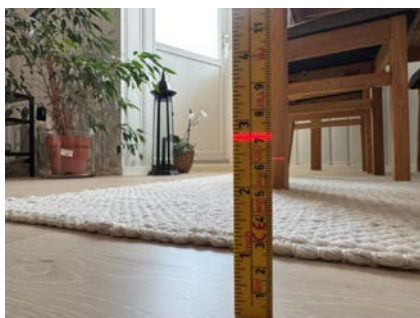
Bilder viser skjevheter i gulv i stue.
