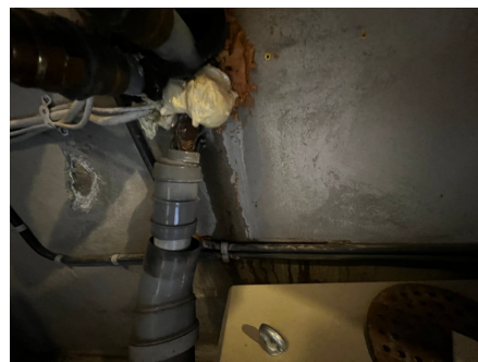
Lekkasje/ fukt gjennomføring i mur
