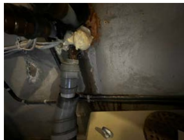
Lekkasje/ fukt gjennomføring i mur
