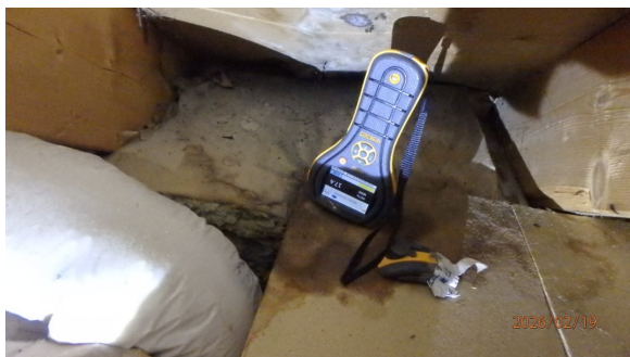
Fuktmåling viser noe forhøyede verdier.
