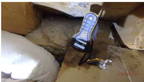
Fuktmåling viser noe forhøyede verdier.
