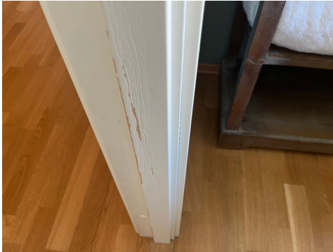
Skader/riper i karm
