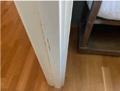
Skader/riper i karm
