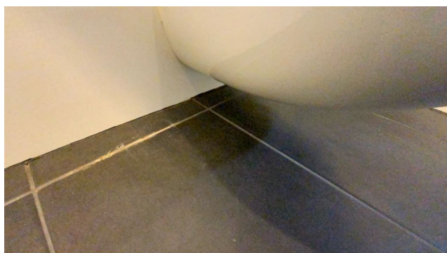
Lekkasjespalte på innebygget sisterner bør opparbeides.
