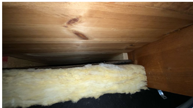
Synlige luftespalter på undertak.
