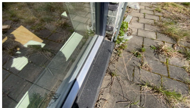
Vindusblikk på kjellervinduer bør utbedres på sikt.
