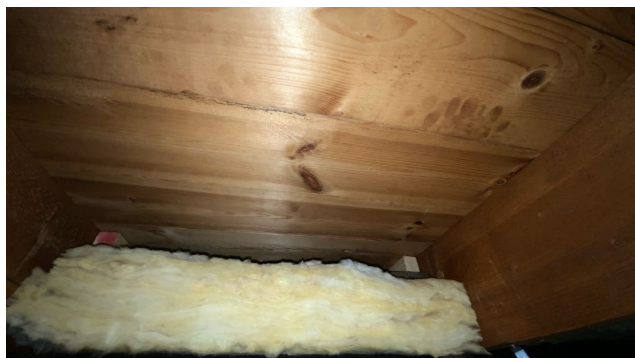
Synlige luftespalter på undertak.
