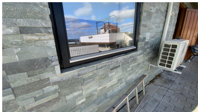
Vindusblikk på kjellervinduer bør utbedres på sikt.
