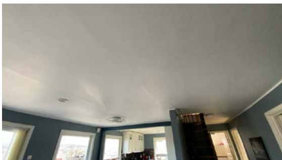
Skjolder på veggoverganger i stue.
