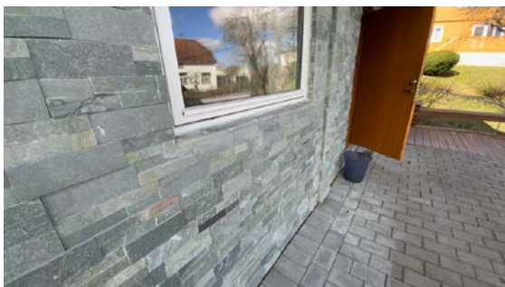
Vindusblikk på kjellervinduer bør utbedres på sikt.
