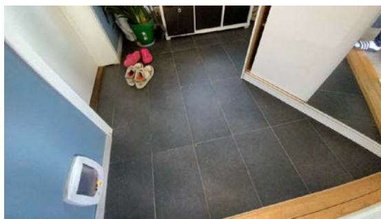
Bomflis i entré. Løse flisfuger.
