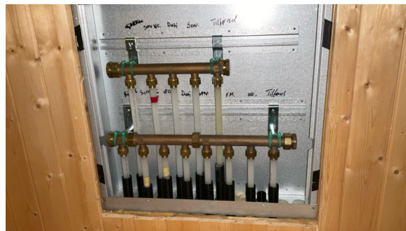
Fordelerskap rør i rør.
