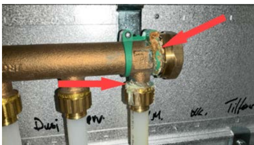
Irr på rørkobling på samlestokk i fordelerskap.
