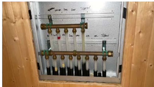
Fordelerskap rør i rør.
