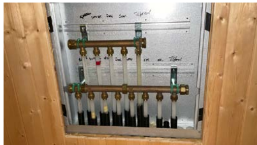
Fordeleskap rør i rør.
