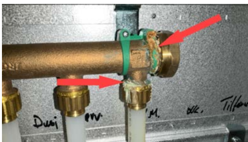
Irr på rørkobling på samlestokk i fordeleskap.
