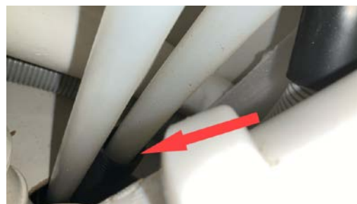
• I kjøkkenskap er det ikke tett tilslutning mellom varerør og vannrør på rør i rør opplegget.
