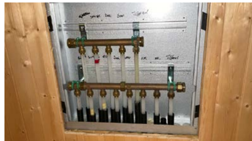
Fordeleskap rør i rør.
