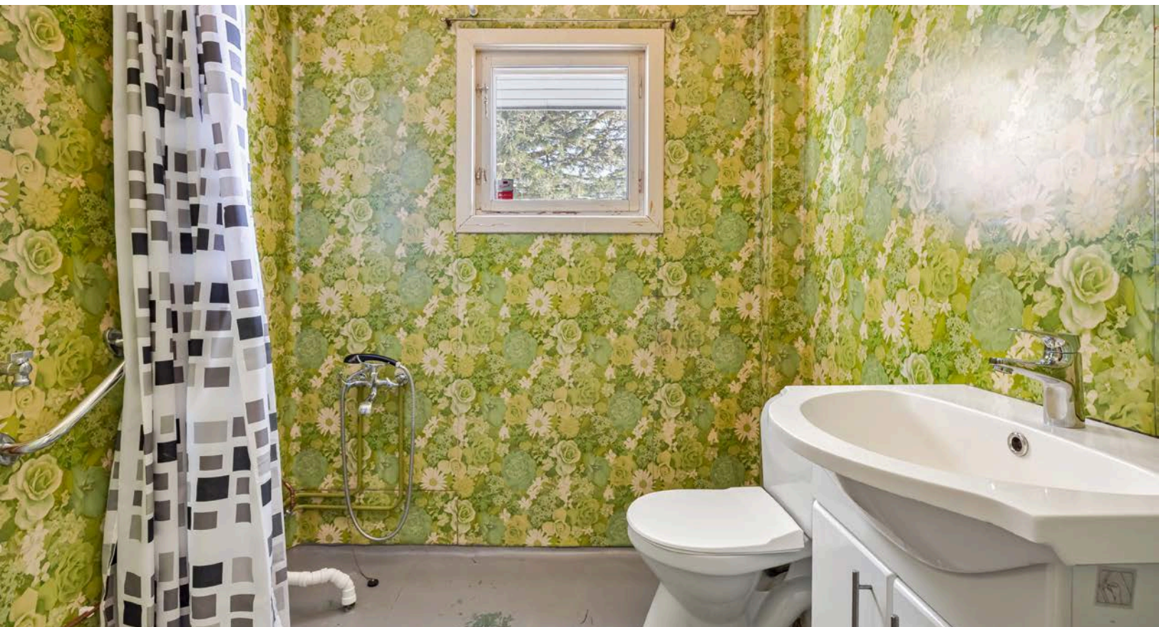
Eldre bad med belegg på gulvet og våtromstapet på veggene. Badet har gulvmontert toalett og dusjbatteri på vegg. Badet må pusses opp for å tåle dagens bruk.
