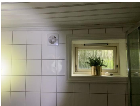
Mekanisk vifte på vegg.
