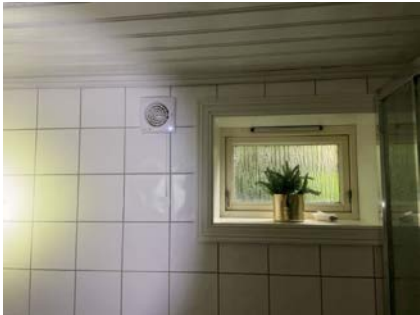
Mekanisk vifte på vegg.
