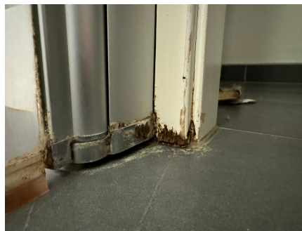
Fuktskade i karmlist v/ skyvedør tilstøtende dusjen.
