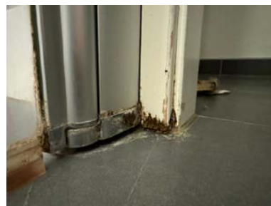
Fuktskade i karmlist v/ skyvedør tilstøtende dusjen.
