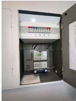
Sikringskap med automatsikringer.
