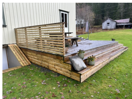
Mangler rekkverk ved mot sør.
