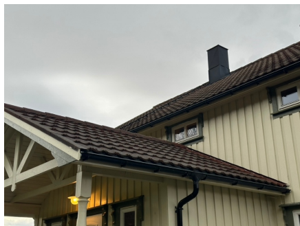
Mangler snøfanger ved tilbygg.
