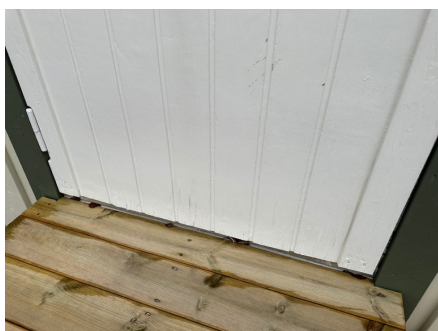
Panel er løsnet i nedre del og en del sprekk i trevirke
