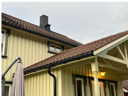
Mangler snøfanger ved tilbygg.
