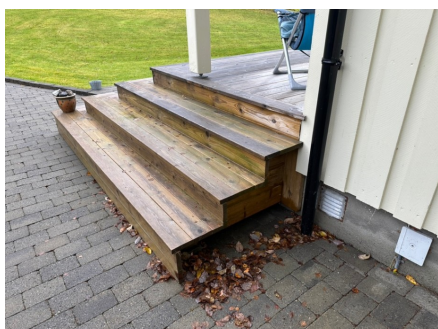
Mangler rekkverk ved hovedinngang.
