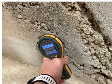
Indikasjon på fukt i betongvegger.
