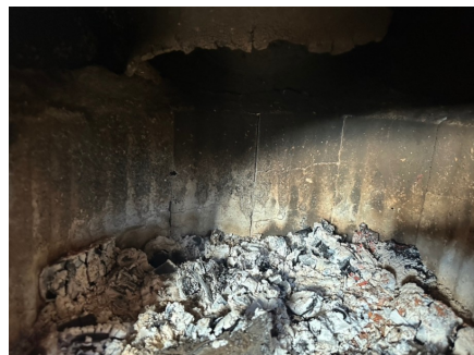
Sprekker i ildfast stein.
