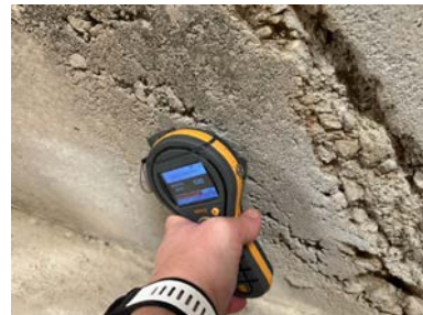
Indikasjon på fukt i betongvegger.
