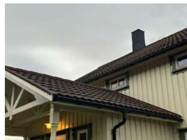
Mangler snøfanger ved tilbygg.
