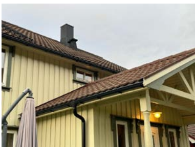
Mangler snøfanger ved tilbygg.
