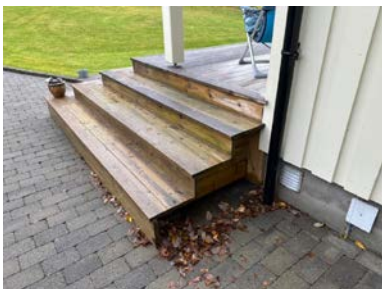
Mangler rekkverk ved hovedinngang.
