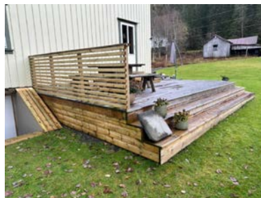
Mangler rekkverk ved mot sør.
