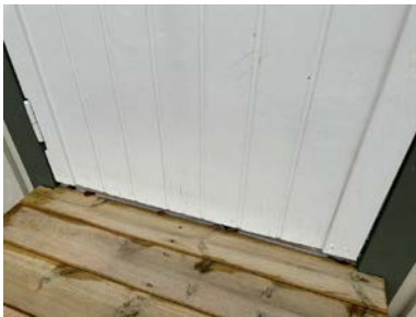
Panel er løsnet i nedre del og en del sprekke i trevirke
