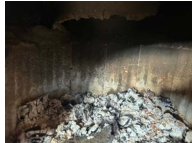
Sprekker i ildfast stein.
