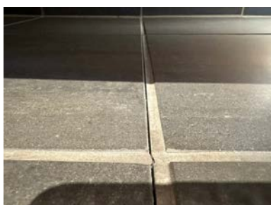
Sprekk i fuger på gulv.
