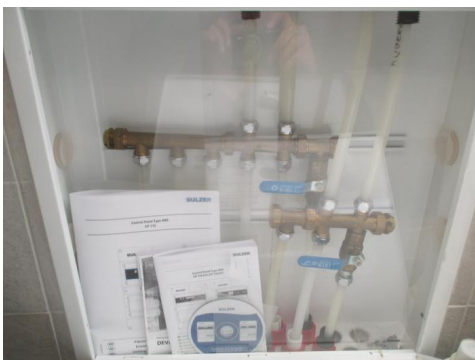
Fordelerskapet er plassert i utvendig bod/vaskerom.
