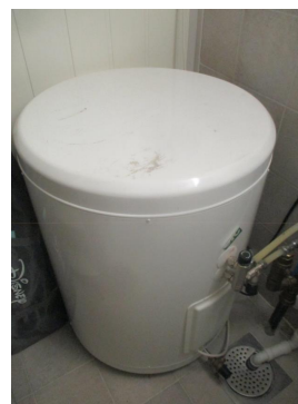
Bereder er plassert i utvendig bod/vaskerom.
