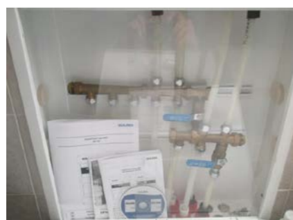
Fordelerskapet er plassert i utvendig bod/vaskerom.
