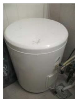
Bereider er plassert i utvendig bod/vaskerom.
