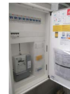
Sikringsskapet er plassert i utvendig bod/vaskerom.
