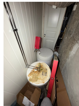
Bereder til kjeller - 2021. Bereder til 1 etasje - 2004
