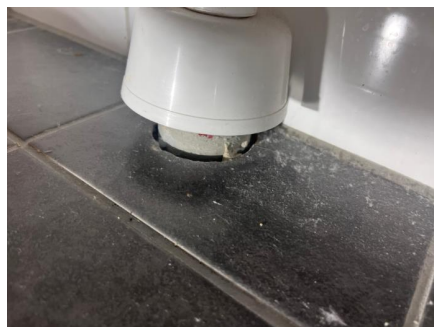
Det er synlig membran opp langs rørgjennomføring i gulv.
