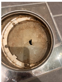
Slukmansjett er ikke tilpasset i sluket
