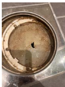
Slukmansjett er ikke tilpasset i sluket
