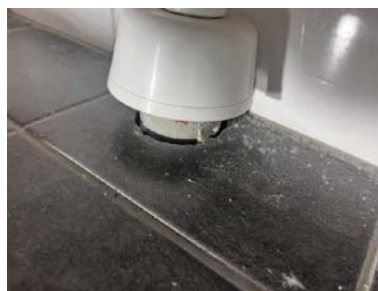
Det er synlig membran opp langs rørgjennomføring i gulv.
