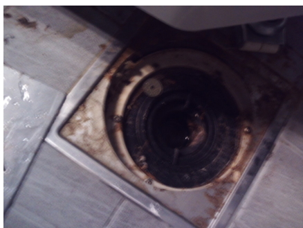
Sluk under dusjkabinett.
