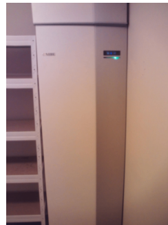
Selve enheten er plassert på teknisk rom.
