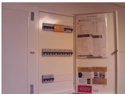
Sikringsskapet er plassert på teknisk rom
