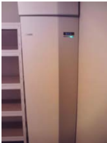
Selve enheten er plassert på teknisk rom.
