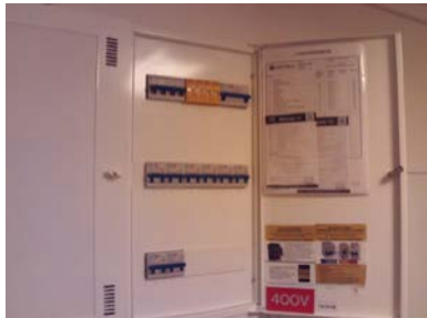
Sikringsskapet er plassert på teknisk rom
