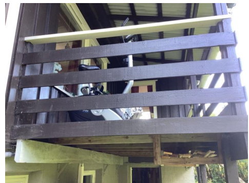
Større åpninger enn anbefalt i rekkverk.
