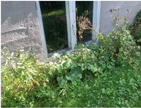
Lav høyde mellom terreng og kjellervinduer.
