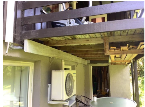
Konstruksjonene er underdimensjonert.
