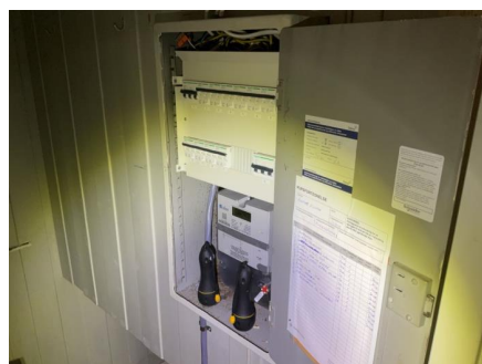
Sikringsskap plassert i trapperom.
