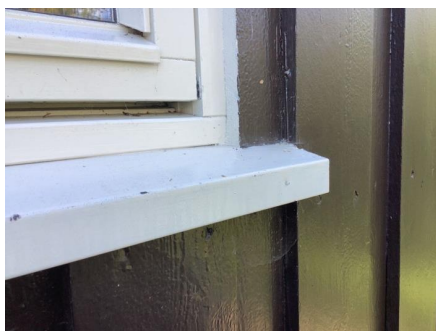
Omramming rundt vinduer er ført ned på beslag, risiko for fuktopptrekk.
