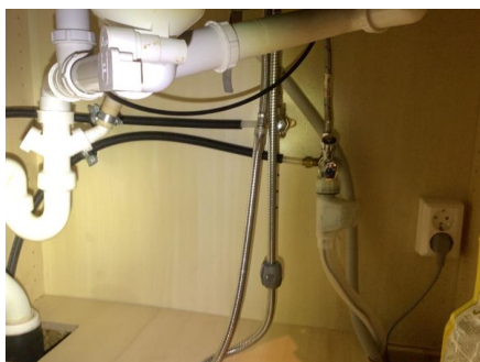
I kjøkkenskap er det ikke tett tilslutning mellom varerør og innerrør for rør i rør system.
