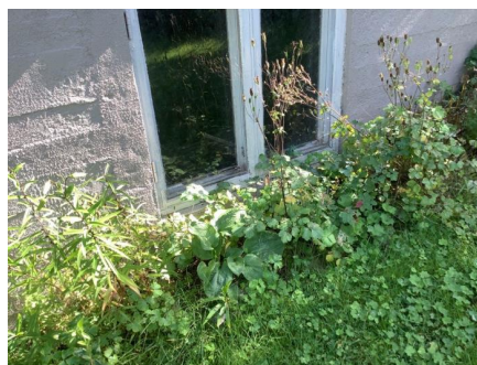
Lav høyde mellom terreng og kjellervinduer.
