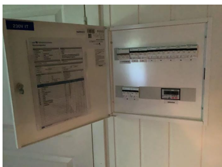
Sikringsskap til hybel.
