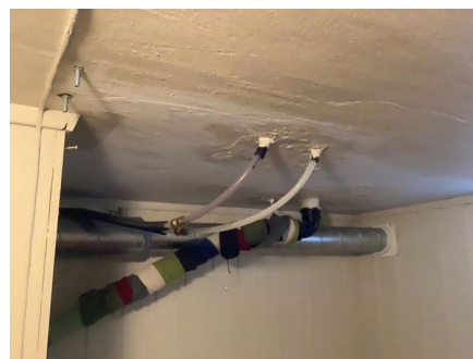
Røropplegg er ikke lagt vannskadesikkert, og er et avvik.
