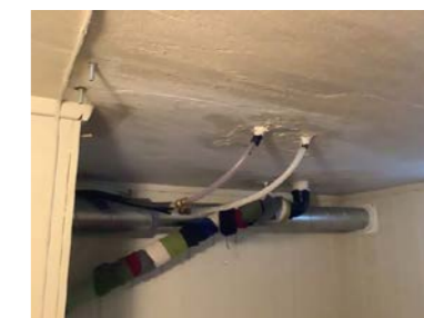
Røropplegg er ikke lagt vannskadesikkert, og er et avvik.
