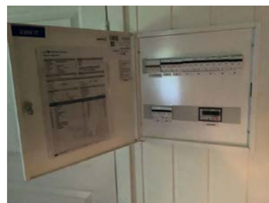
Sikringskap til hybel.
