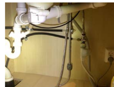
I kjøkkenskap er det ikke tett tilslutning mellom varerør og innerrør for rør i rør system.
