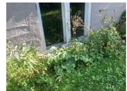
Lav høyde mellom terreng og kjellervinduer.
