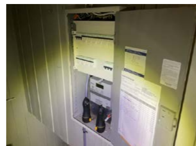
Sikringskap plassert i trapperom.
