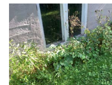
Lav høyde mellom terreng og kjellervinduer.
