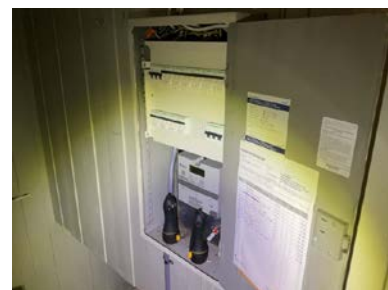
Sikringskap plassert i trapperom.
