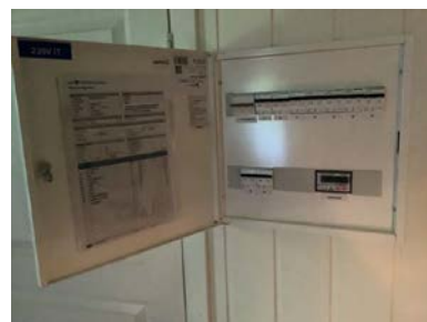
Sikringskap til hybel.
