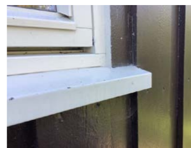
Omramming rundt vinduer er ført ned på beslag, risiko for fuktopptrekk.
