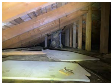
Spor etter skadedyr er registrert, ukjent omfang.
