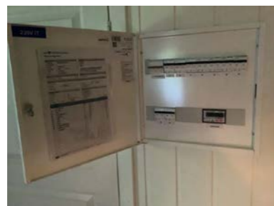
Sikringskap til hybel.
