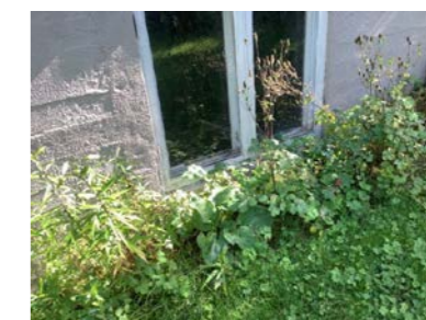
Lav høyde mellom terreng og kjellervinduer.
