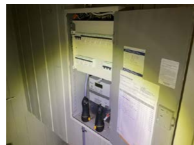
Sikringskap plassert i trapperom.
