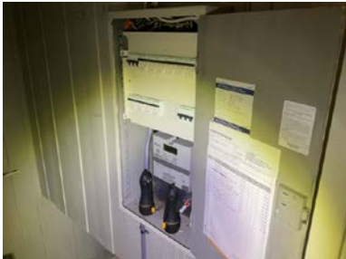
Sikringsskap plassert i trapperom.
