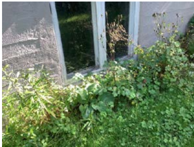
Lav høyde mellom terreng og kjellervinduer.
