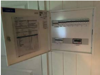
Sikringsskap til hybel.
