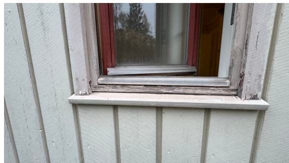
Enkelte vinduer er noe utvendig værslitt.
