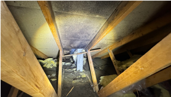
Fuktmerker/svertesopp i taktro.
