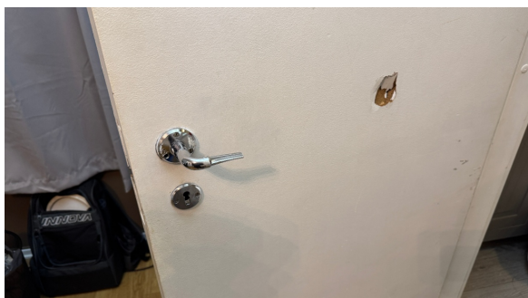
Døren har skade og knekt dørvrider.
