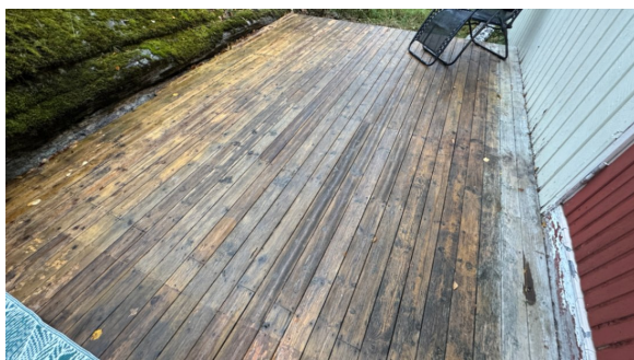
Terrassedekke er noe værslitt.
