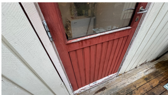
Terrassedør er utvendig værslitt.
