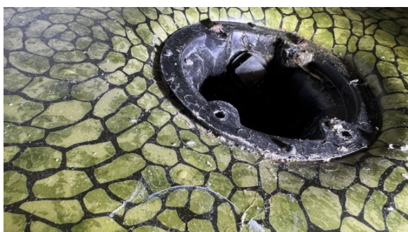
Sluken mangler en skrue på klemringen.
