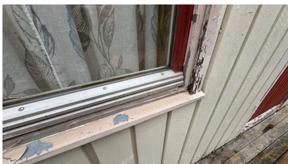
Enkelte vinduer er noe utvendig værslitt.
